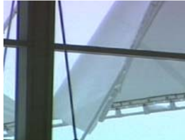
图 1 丹佛国际机场膜屋盖被撕裂
