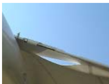
图 9 张拉不当造成膜材撕裂
