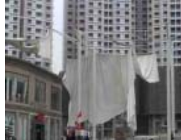
图 2 成都某膜结构被大风摧毁
