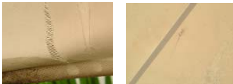
图 21 膜面破损没有及时修补
