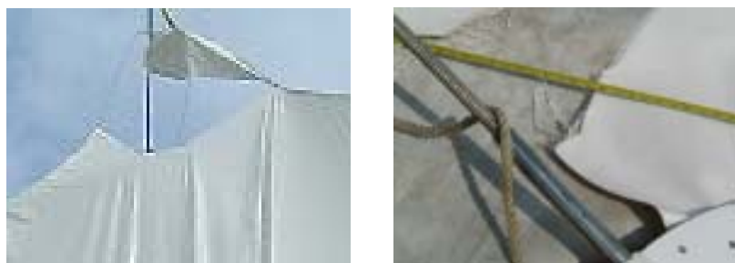
图 8 吊装方式不当加之膜角切口设计不合理造成膜材撕裂
