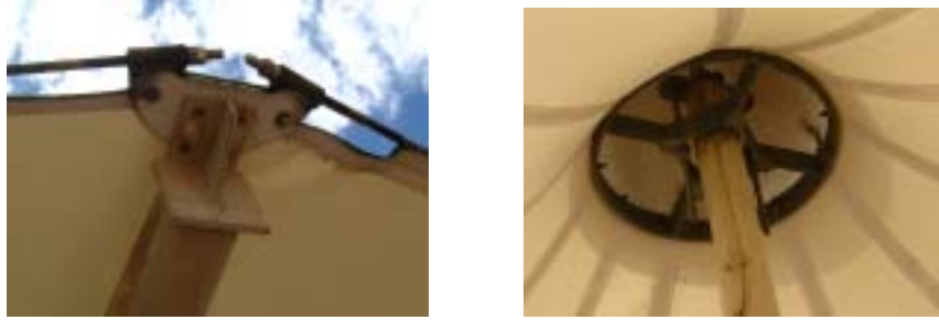
图 14 金属构件发生锈蚀
