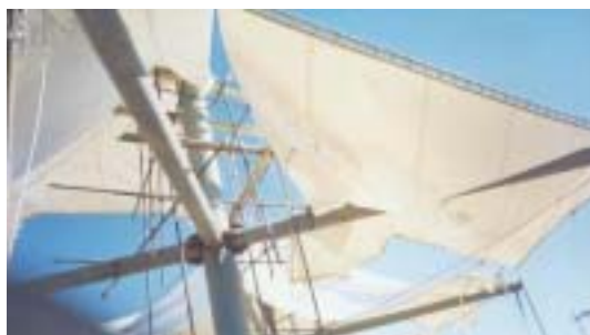
图 1 国内某工程在施工中出现膜材被风撕裂
